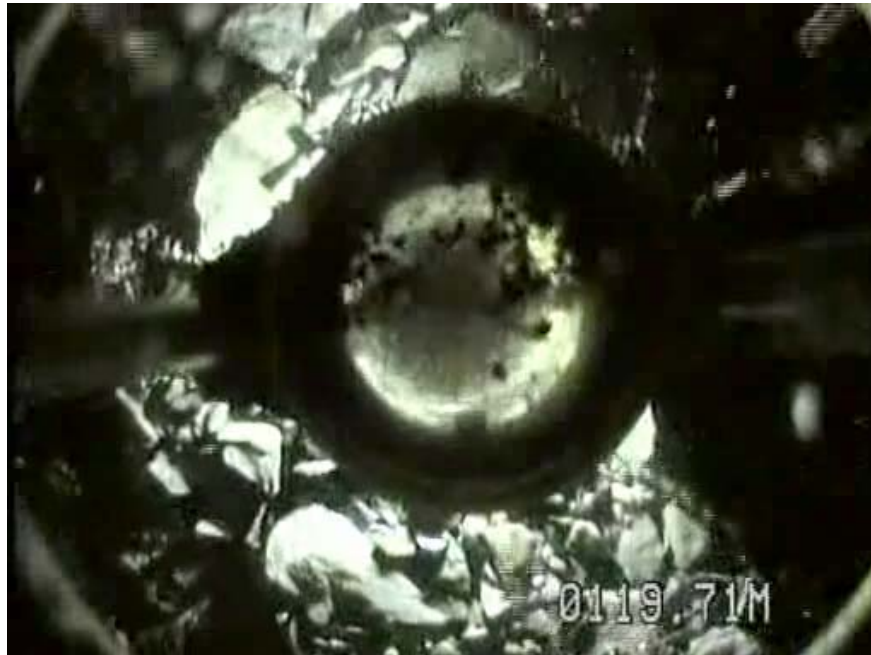
Figura 4.8a. Bloqueo ocasionado por escombros tal y como se ve a 119.71 metros
