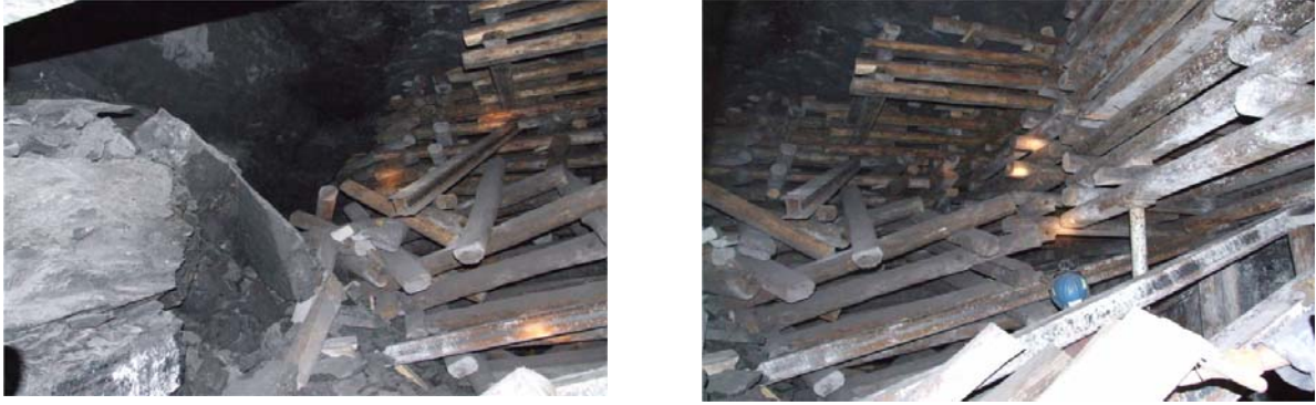
Figura 2.6 Revestimiento colapsado en la diagonal 13.
