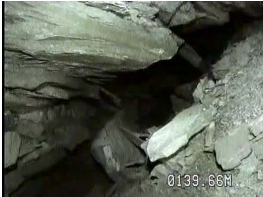
Figura 4.15 Pozo de degasificación 11 obstruido por la caída de rocas a 139 metros.
