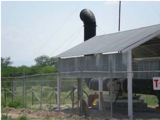
Figura 3.1 Ventilador del barreno de purga.
