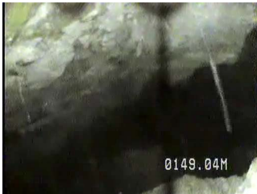
Figura 4.14 Evidencia de caída de roca en el T-3
