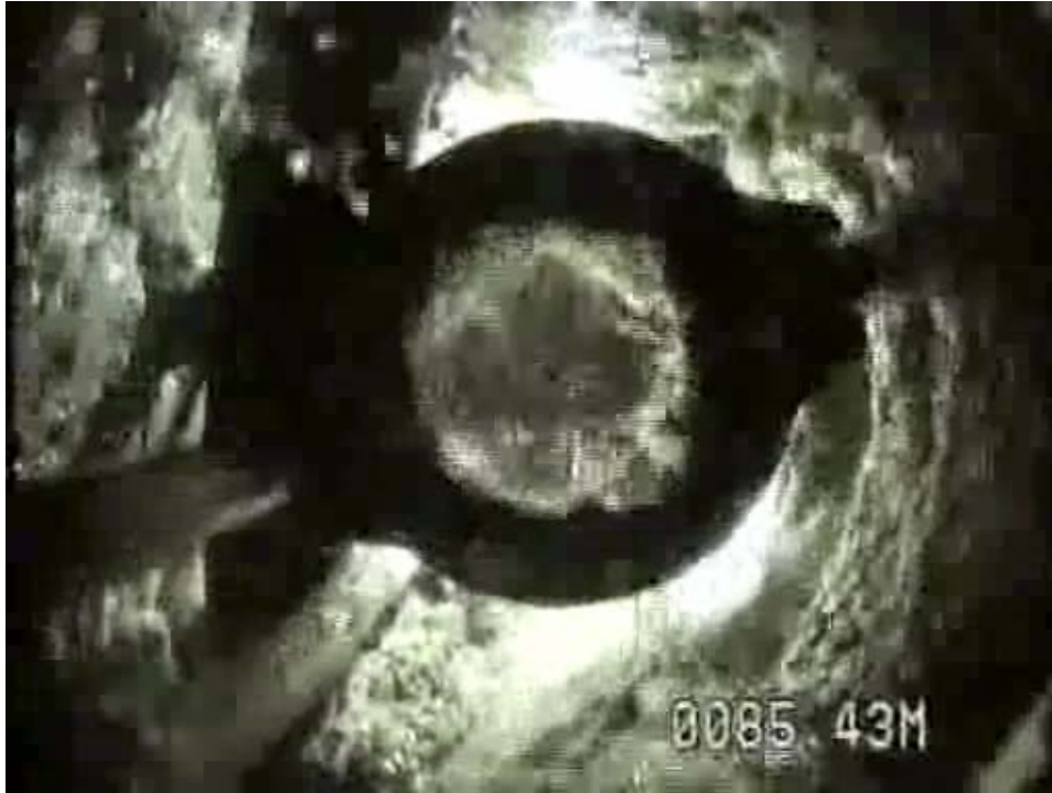
Figura 4.23 Agua corriendo en el pozo M-7 obstruido a 85 metros.
