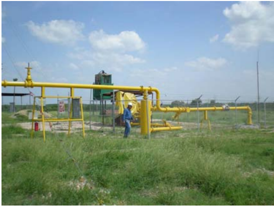
Figura 3.4 Pozo de desgasificación 4.
