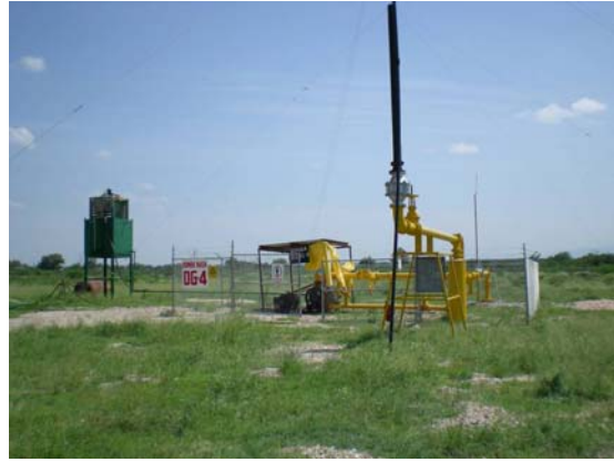
Figura 3.5 Pozo de desgasificación 4.
