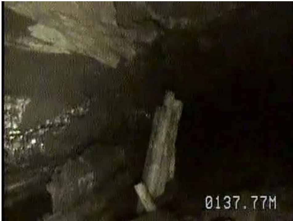
Figura 4.21 Caída de roca del C-5
